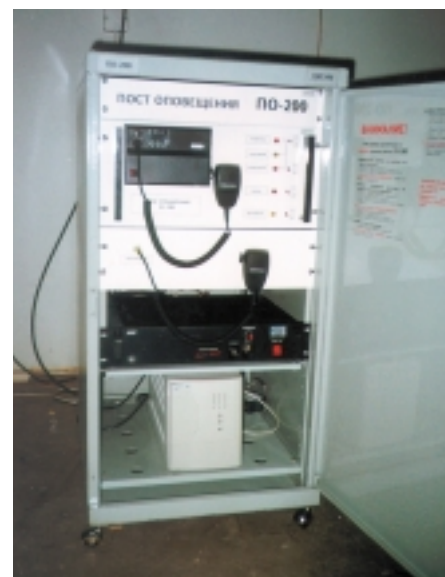
Рис. 2. Системный блок поста оповещения с открытой дверцей
